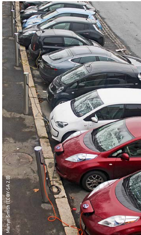
Norwegen zeigt, wie es geht: Allein in Oslo wurden bereits an 1.300 öffentlichen Parkplätzen Steckdosen installiert, deren Nutzung in den Parkgebühren inkludiert ist. Weitere 700 Parkplätze sollen noch dieses Jahr elektrifiziert werden.
