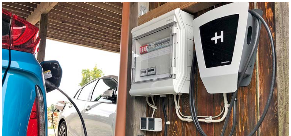
Zwei der vom ADAC als „sehr gut“ getesteten 11-kW-Heidelberg-Wallboxen mit festem Kabel wurden im Carport eines Mehrfamilienhauses an eine neue Unterverteilung mit Schutzschaltern sowie Überspannungsschutz und geeichten Stromzählern angeschlossen. Für den leichten Anschluss einer dritten Ladestation wurde eine Ausbaureserve vorgesehen.
